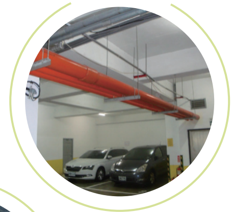
大樓污水管與污水下水道連結
