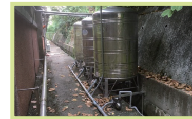
空調冷凝水回收
