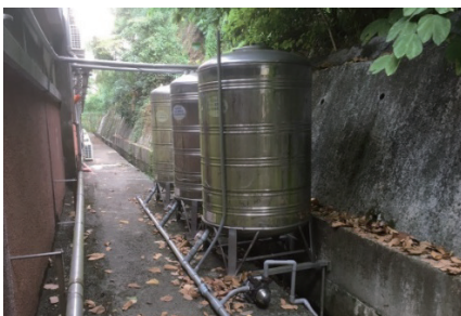
空調冷凝水回收
